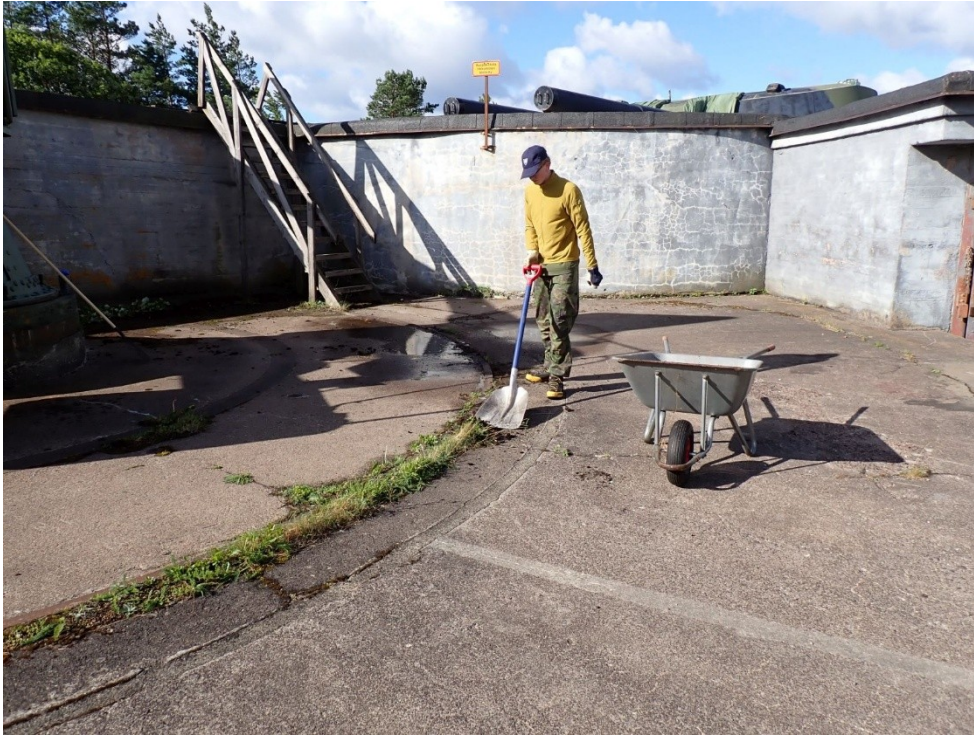
Kuva 37. Tykkipatterin rakenteisiin kertyy kariketta ja kasvillisuutta, mitkä pitävät rakenteet kosteina.
